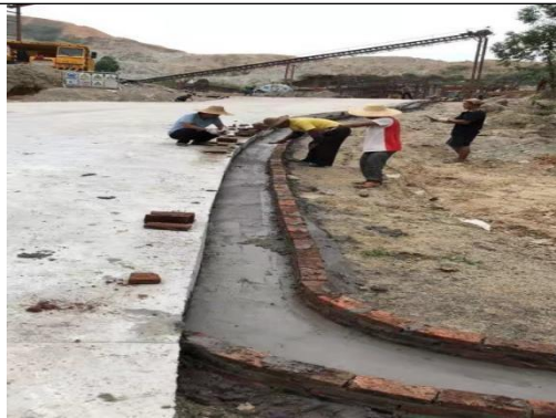
矿区排水设施现状
