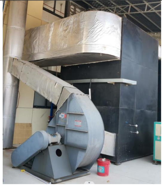
有机废气处理装置（RTO）
