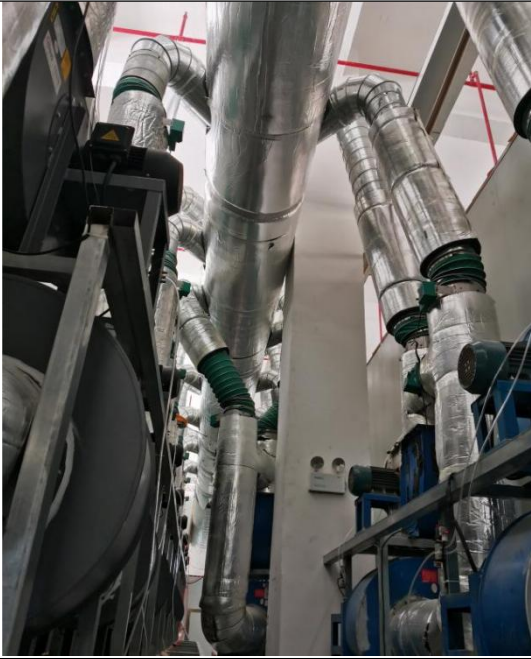
废气收集措施
