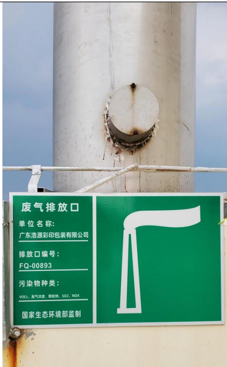
废气排放口 FQ-00893（近景）
