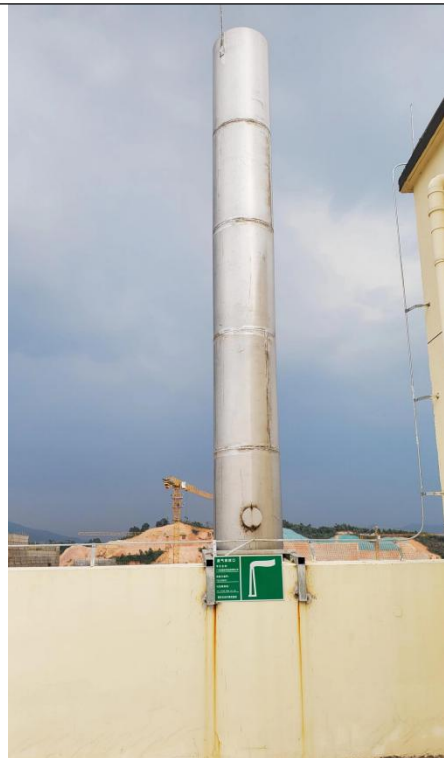
废气排放口 FQ-00893（远景）
